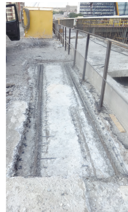
Рис. 1. Вскрытие ветвей каната №19 на длине 5,2 м над опорой 3, верхняя коробка, блоки Б16 – Б17
