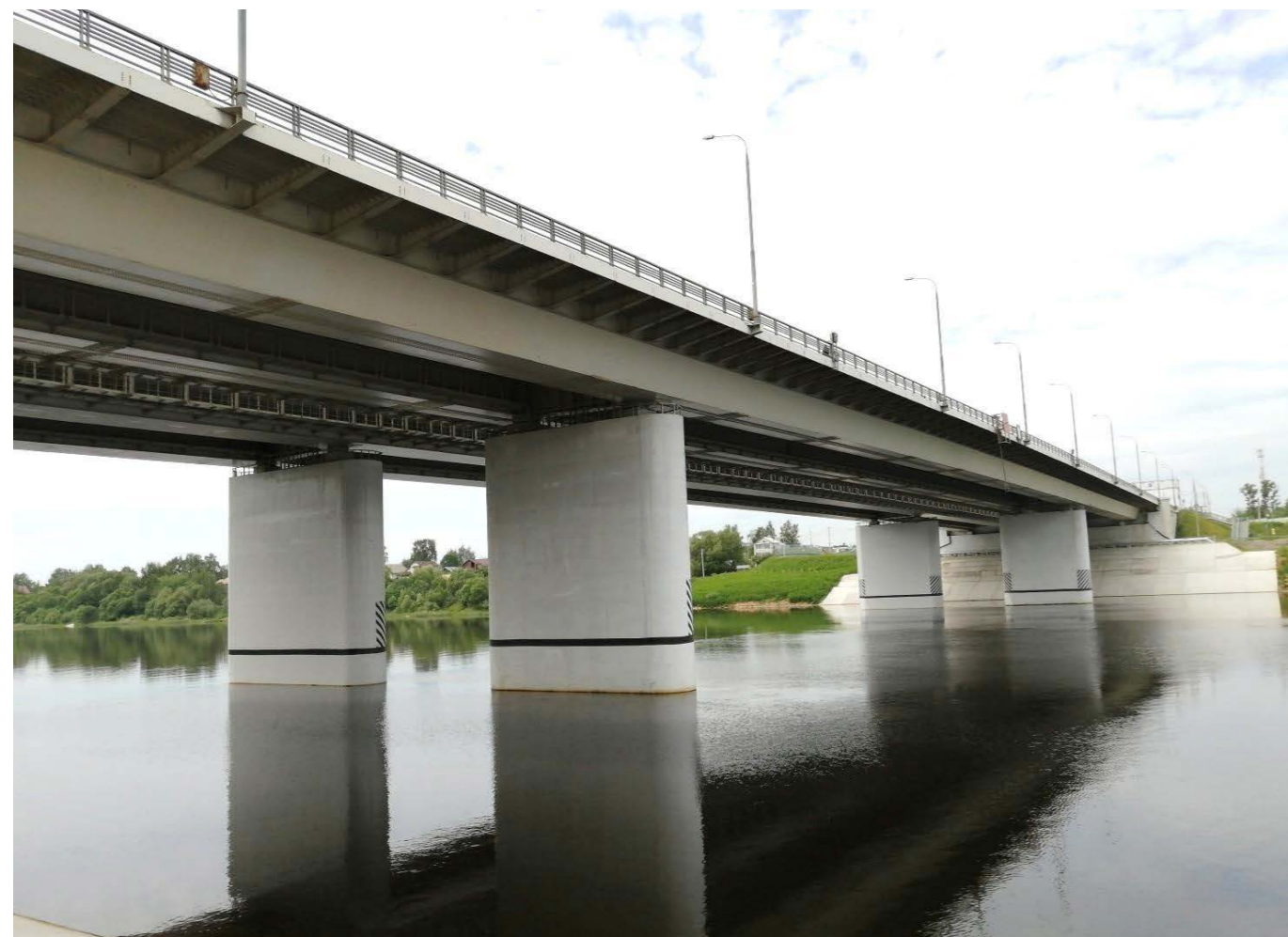
Рисунок 1. Общий вид мостового перехода через Волгу на 176-м км автодороги М-10 «Россия»
